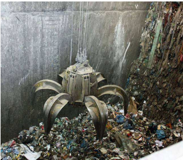
Mit Kränen wird der Müll vom Müllbunker in die Verbrennungsöfen befördert.
